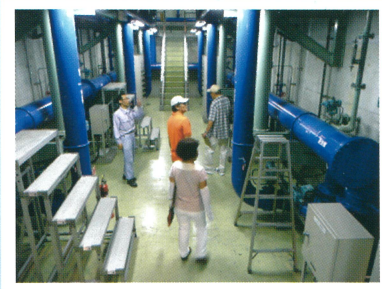
水質浄化センター内部
